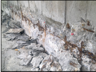
Betonabdrückung durch zu geringe Betondeckung - Dauerhaftigkeitsproblem
