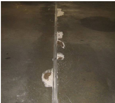
Gebrochener Estrich im Parkhaus - Estrich wird hinterläufig (Dauerhaftigkeitsproblem) und Stolpergefahr bzw. Beschädigung von Fahrzeugen (Verkehrssicherheit)
