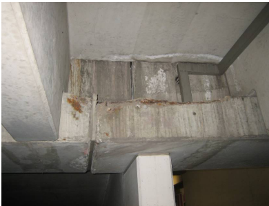
Ablaufspuren und stark korrodierte Bewehrung an einem Konsolband durch undichte Bauwerksfugen und Chlorideintrag (Streusalz) — Standsicherheitsgefahr!
